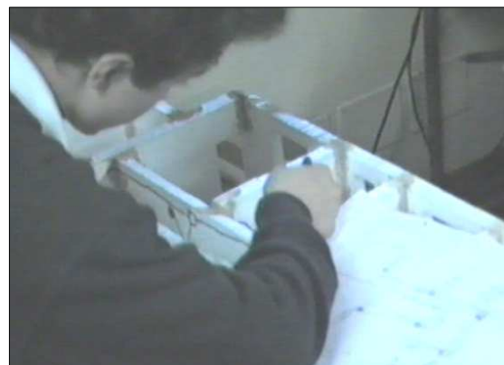
Con un pennarello viene disegnato il percorso delle canalette che ospiteranno il filo e segnata la posizione di interruttori, lampade e morsetti.
